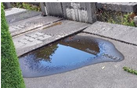
Door de golving blijft het water staan
