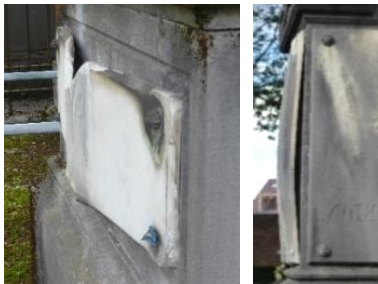
De plaat is gebogen
